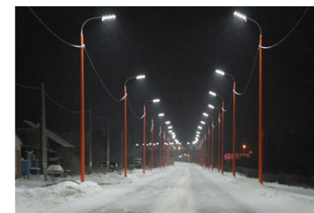
Центральная улица в г. Черемхово, Иркутская область Светильники BEST STREET-04 150
